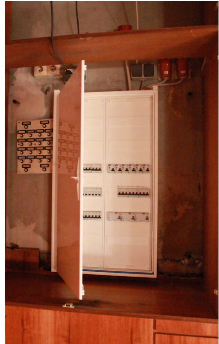
neuer UV Saal mit integriertem Schaltertableau – Foto: weiter Flur e.V.
