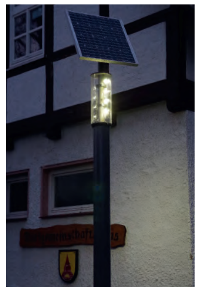
Selbstregelnde LED-Solar-Leuchten an einem Dorfplatz
